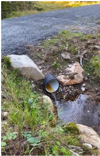
Bilde 4: Den lille bekken som passerer under bilveien i et rør som ligger høyt i vegkroppen.
